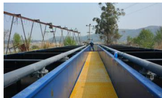
绵阳乡镇污水处理
